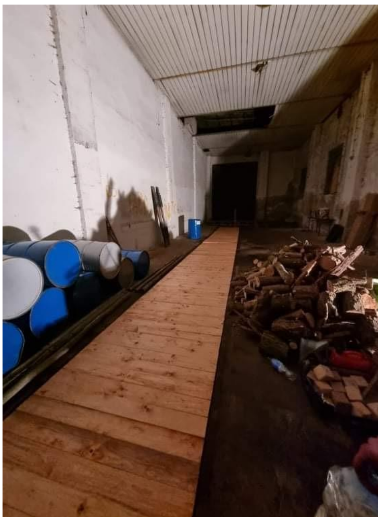
Zabezpieczenie i wstępne przygotowanie obiektu parowozowni do prac modernizacyjnych w ramach zadania „Wykorzystanie zdegradowanych terenów pokolejowych w Krupskim Młynie”, wykonane przez członków i sympatyków Holistycznego Stowarzyszenia „Frymark” (zdj. za stroną fb Stowarzyszenie Frymark)
